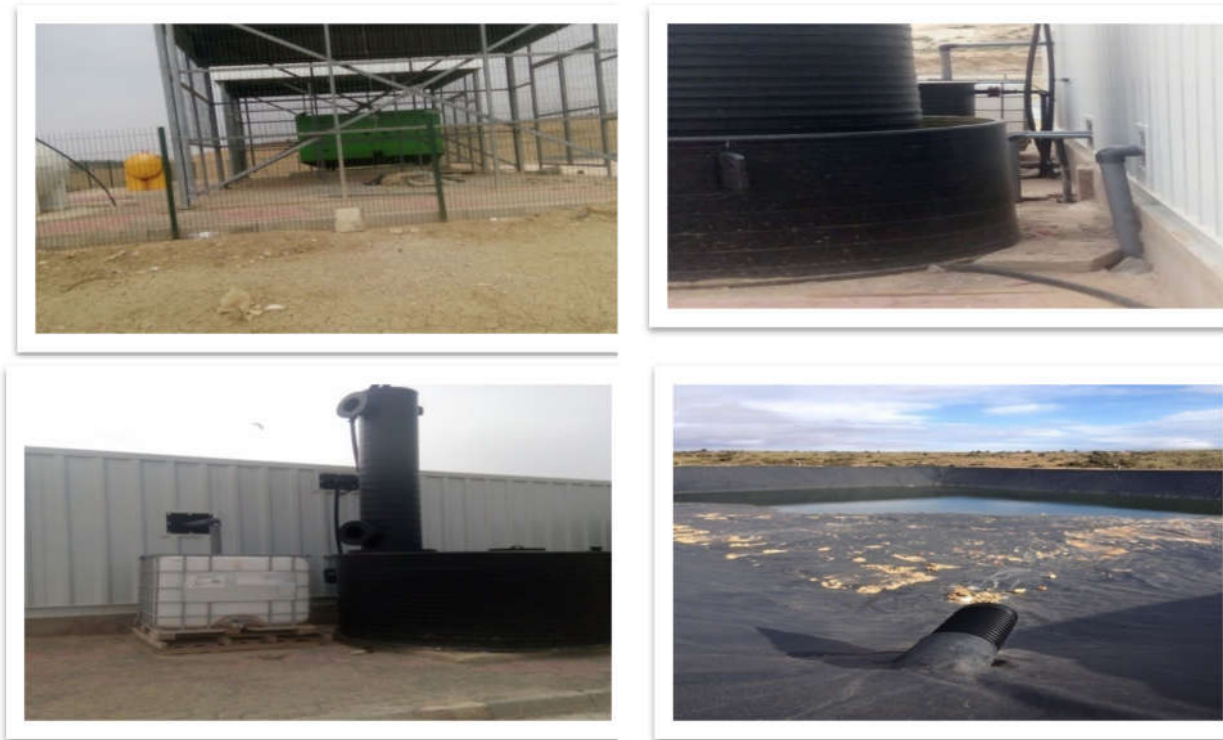
Figure 32 : une station d'épuration des lixiviats
